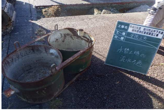
使用したろ過装置
