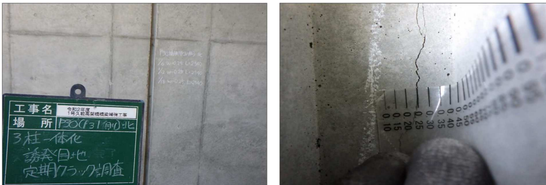
写真 ひび割れ調査結果(継続的な計測)
