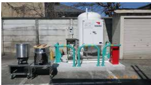
LPガス自家発電設備
