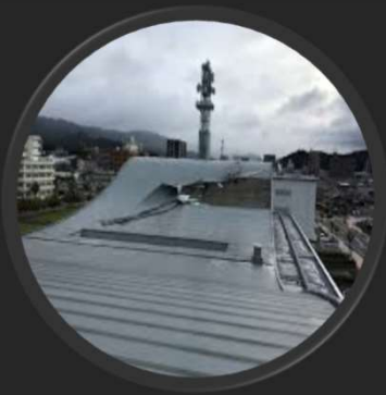
強風で屋根がめくれる
